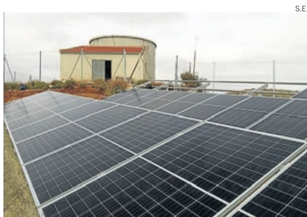
Las placas solares están en los depósitos.
